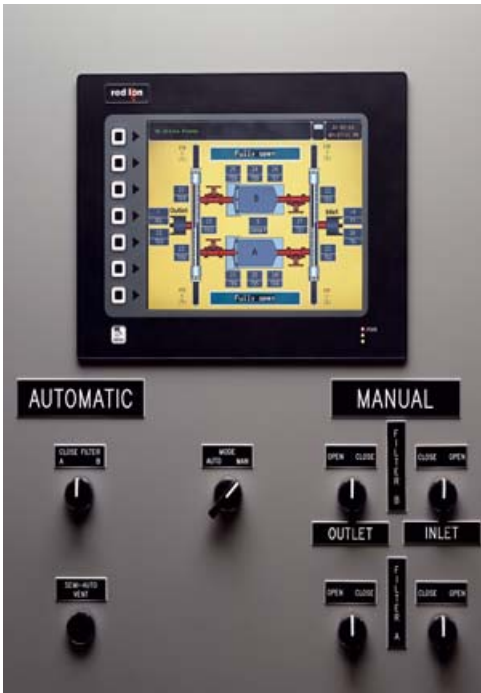
马格公司过滤器的控制系统
